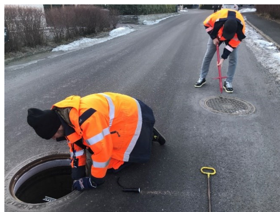
Nivåmätare för att detektera tillskottsvatten placeras ut i Göteborg.
