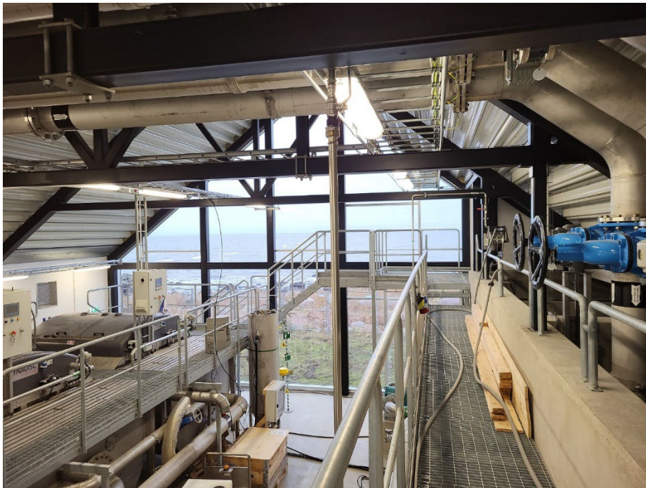
Reningsverket i Kivik som utvärderas i ÅÄÖ-projektet.
