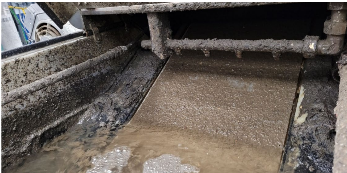
Mer än 70 % av det partikulära kolet i avloppsvattnet avskiljs i det roterande bandfiltret. Nästan alla partiklar större än 5-10 µm filtreras bort. (Foto: David Gustavsson).
