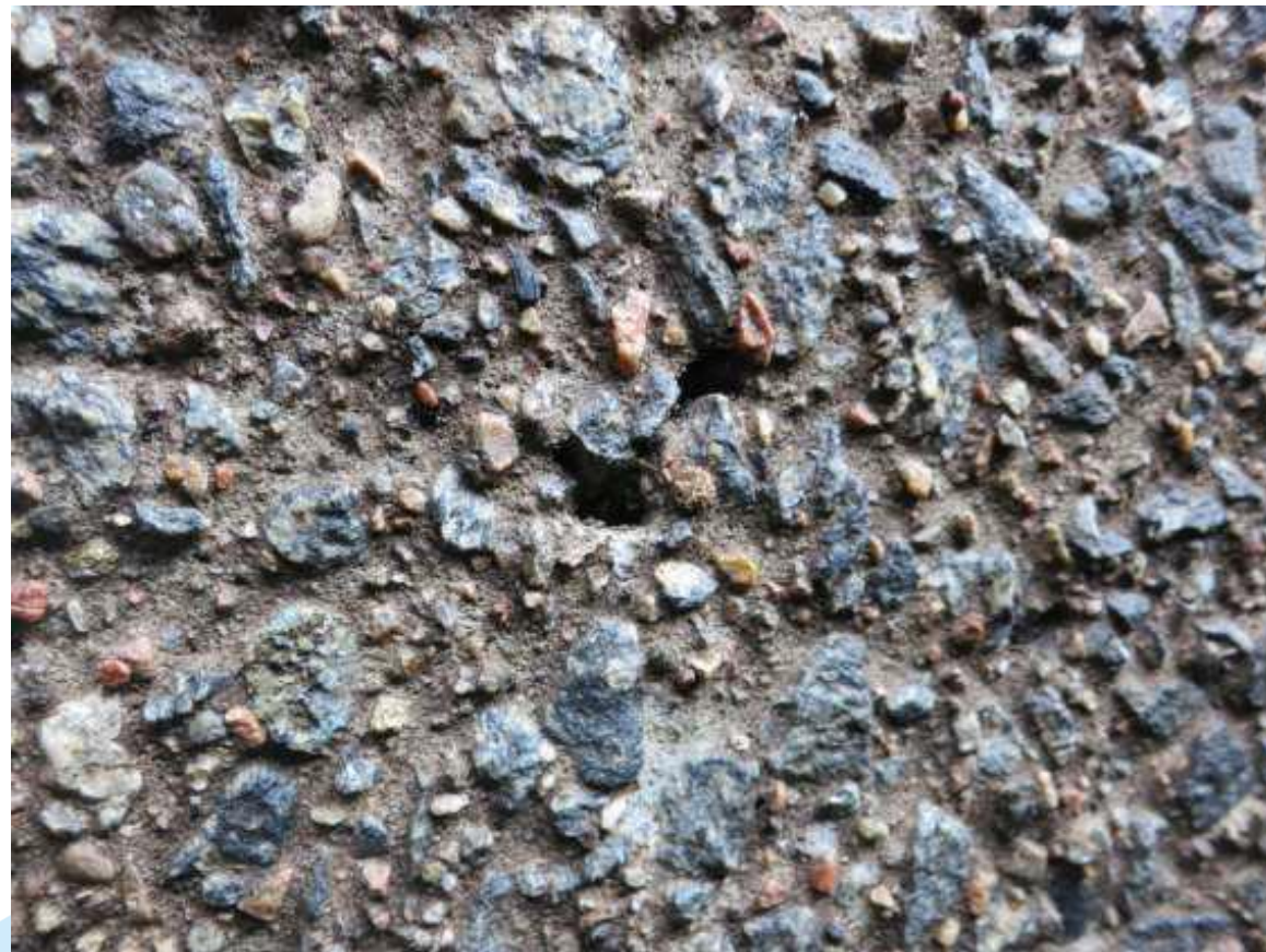
Från besiktning 2019, ballaststen har lossat
