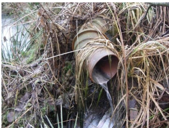
Bild 4. Spillvattnets inloppsrör. Privat bild.
