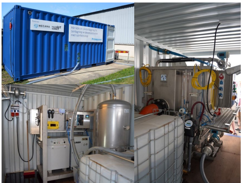
Figur 10. Pilotanläggningen från Primozone.
