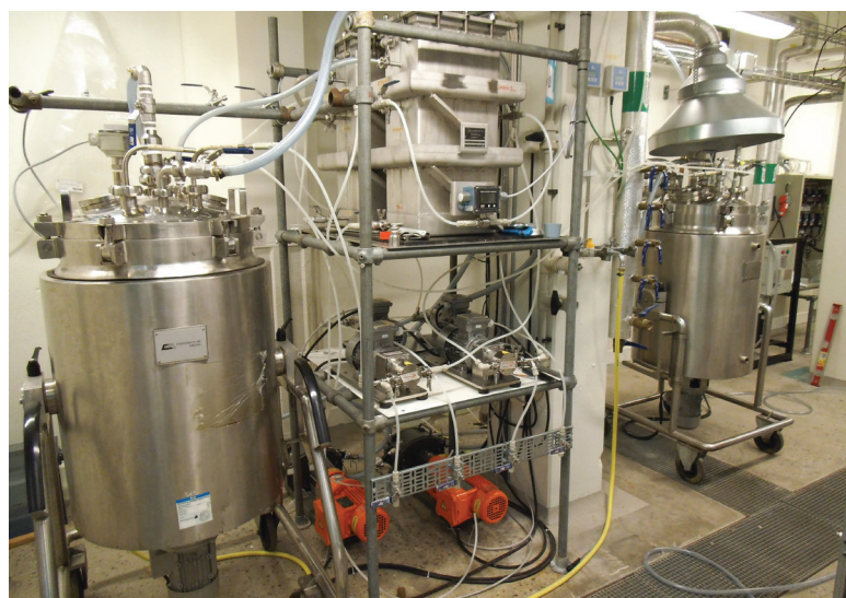
Pilotanläggning på LTH för anaerob rening av industriavloppsvatten i membranbioreaktorer.
