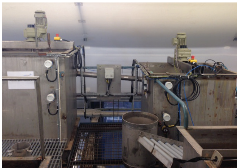
Anammox-piloten på Sjölunda avloppsreningsverk.
